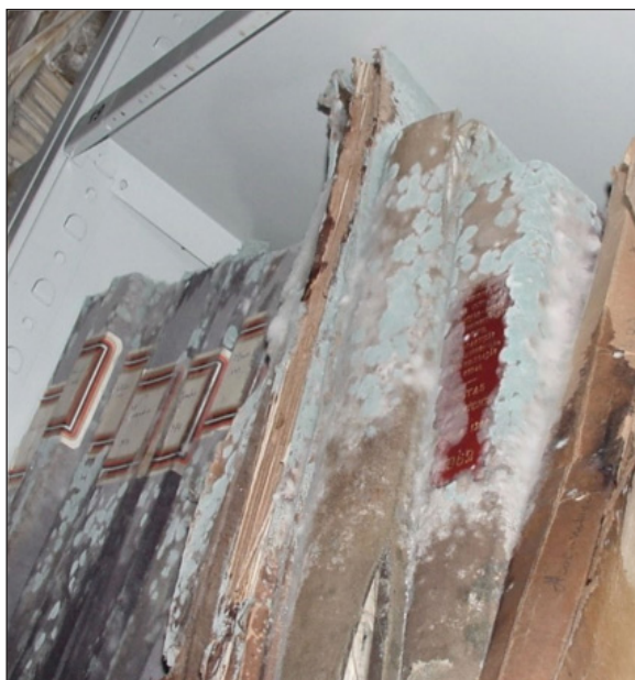
تصویر ۱- شیوع قارچ در نتیجه نشست آب از سقف یک مخزن آرشیو (AHU-DGLAB، پرتغال، ۲۰۰۵).
